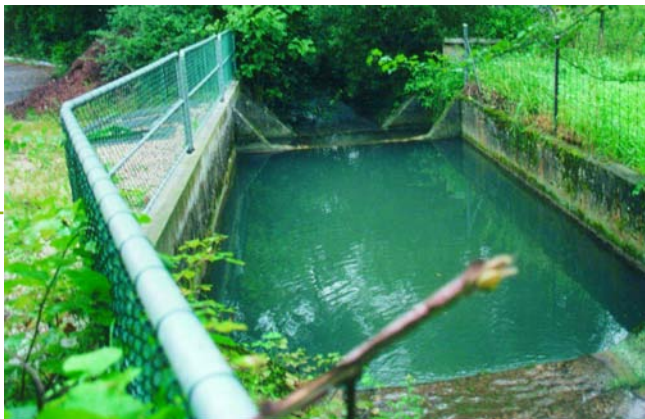
Geschiebefang als Betonkonstruktion.
